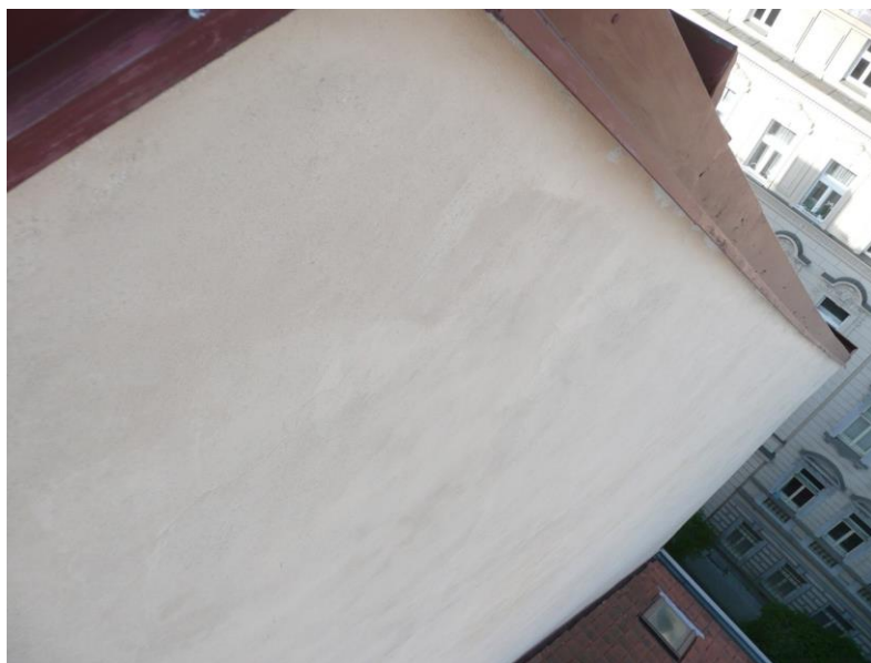
05 – LEMOVÁNÍ SEVERNÍHO ŠTÍTU (nekvalitně provedené detaily, neočištěné povrchy před nátěry)
