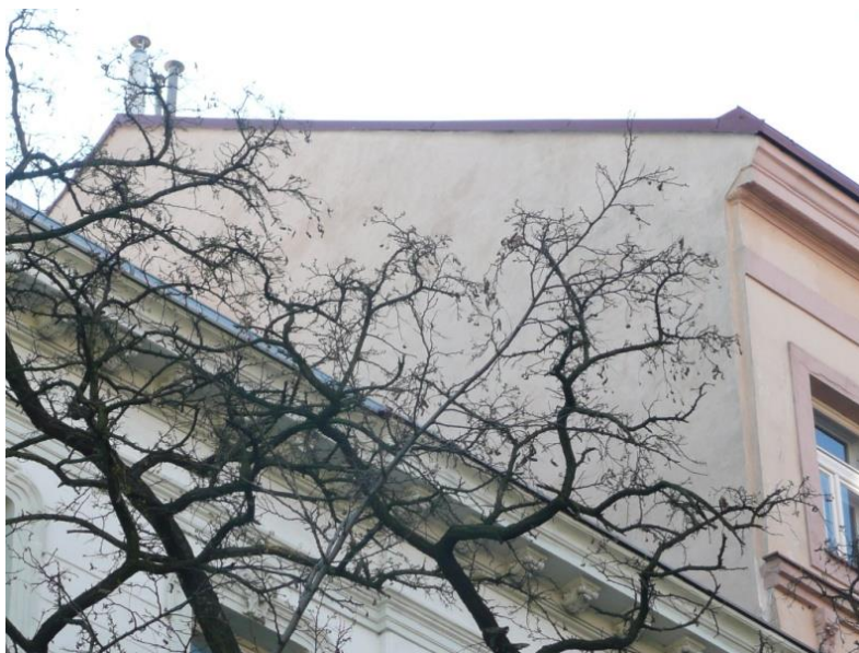
04 – SEVERNÍ ŠTÍT (zvětralý nátěr; štuk)
