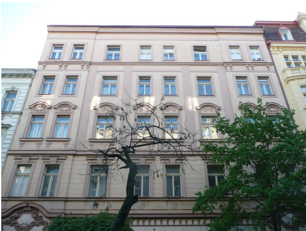
01 – ULIČNÍ FASÁDA – horní část (nesourodost zbytků původního řešení a úpravy z 20. Let)
