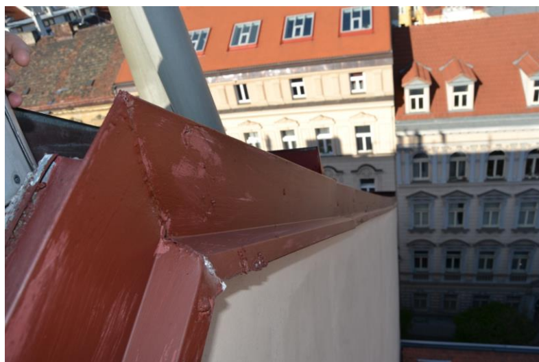
06 – LEMOVÁNÍ SEVERNÍHO ŠTÍTU (nekvalitně provedené detaily, neočištěné povrchy před nátěry)
