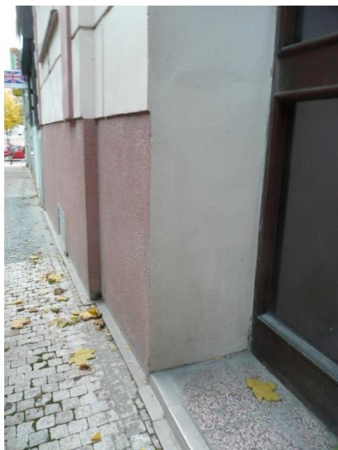
20 - SOKL – odseknutím původního soklu byla „podříznuta“ fasáda včetně pilastrů
