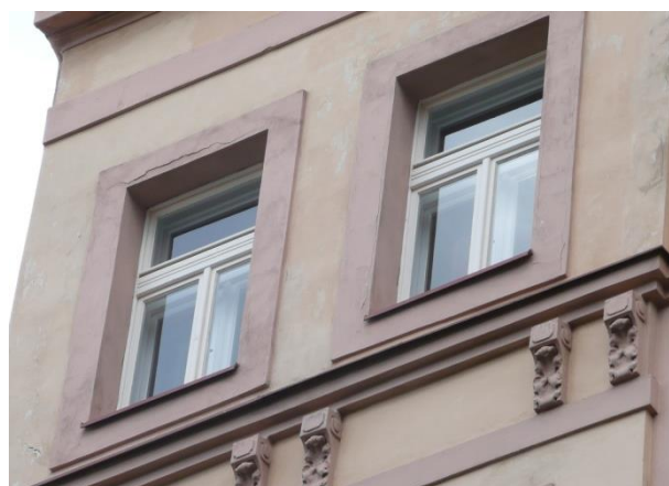
15 – PORUCHY OSTĚNÍ, OSIŘELÉ KONZOLKY Z PŮVODNÍ ŘÍMSY
