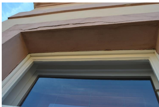
10 – TRHLINKY OSTĚNÍ (5. NP, nekvalitně provedené šambrány)
