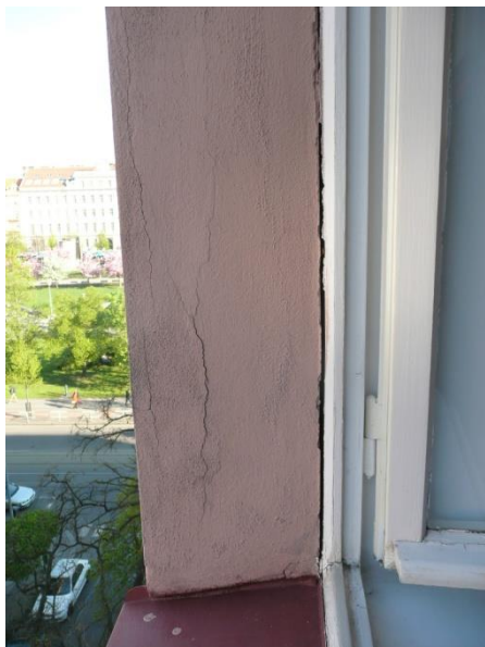
11 – TRHLINKY OSTĚNÍ (5. NP, nekvalitně provedené šambrány)
