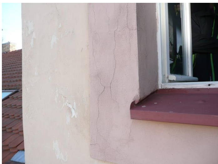
13 – TRHLINKY SPALETY (5. NP, nekvalitně provedené šambrány)
