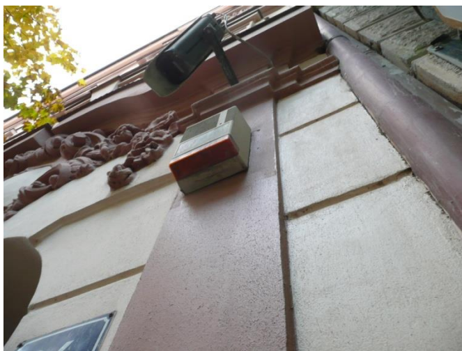
19 – PARTER – ANTIGRAFITTI NÁTĚR – závada – nepřípustně lesklý film
