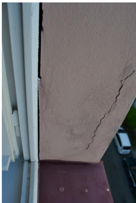
12 – TRHLINKY OSTĚNÍ (5. NP, nekvalitně provedené šambrány)
