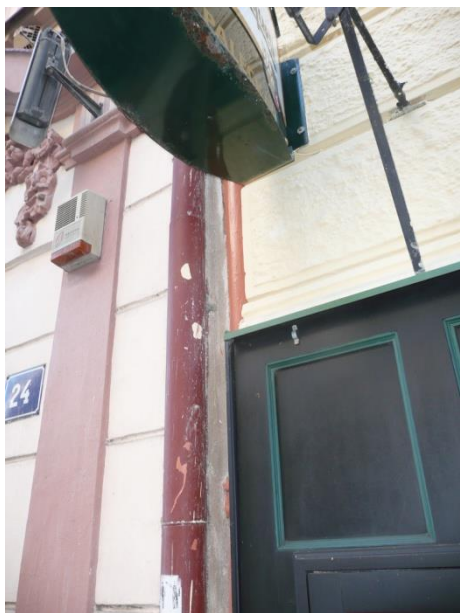
18 – DEŠŤOVÝ SVOD PŘÍZEMÍ PODLAŽÍ – nekvalitní provedení detailu za svodem, znečištěný svod omítkou
